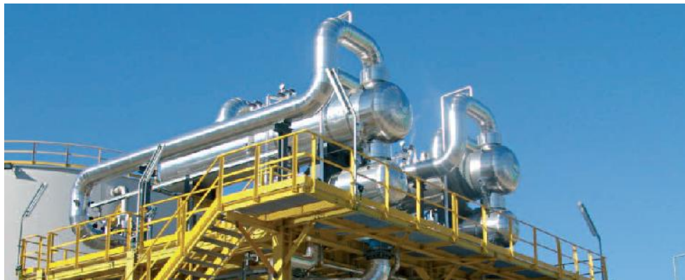
Scambiatori dell'impianto di teleriscaldamento
